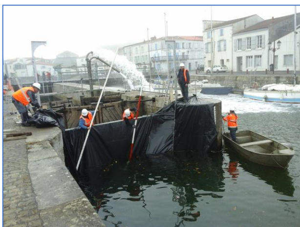
Exemple de mise en place de batardeau sur la Sèvre Niortaise.
