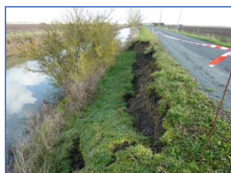
Etat de dégradation initial
