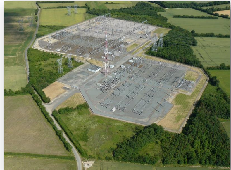
Poste de 400 kV de Granzay (Deux-Sèvres) – 10 ha
